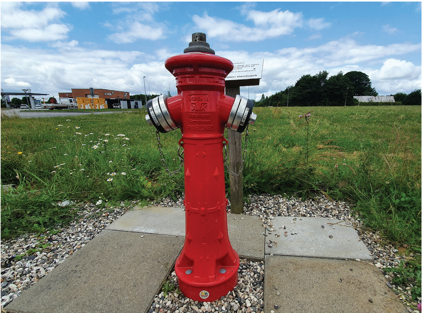
Poteau incendie avec bouchon VIDI Caps. L'utilisation d'un poteau incendie affecte la pression de la zone où il se trouve. Grâce au bouchon installé, il devient plus facile de faire la distinction entre une fuite et l'utilisation d'un poteau.
